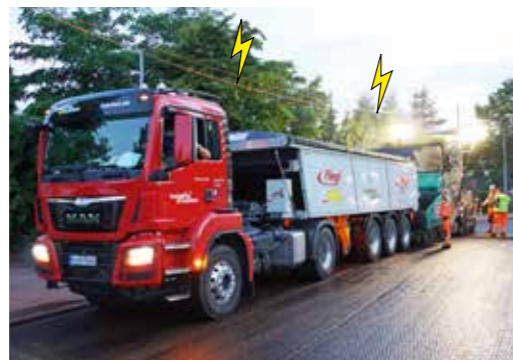
Einsatz im kommunalen Straßenbau: Keine Gefahr bei Stromleitungen
