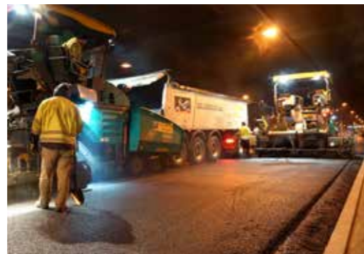
BV Wien, Kaisermühltunnel Einsatz von 12 Fahrzeugen. ASS 372
