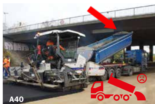
Vorher: Unfallgefahr und Stop and Go - ein Problem im Asphaltbau
